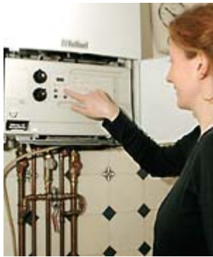
Die Heizung optimal einstellen
